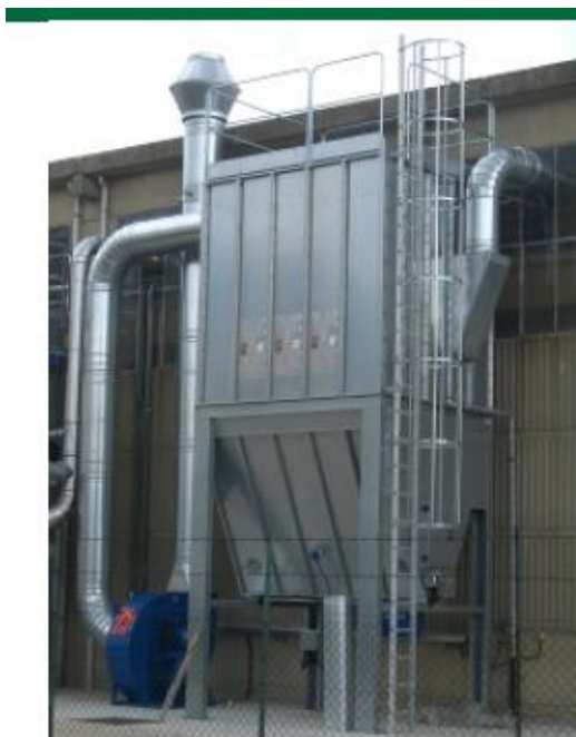
Dispositif de traitement de l'air par filtre à manches et cheminée d'éjection de l'air épuré
